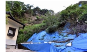
豪雨の度に土砂崩れが多発
